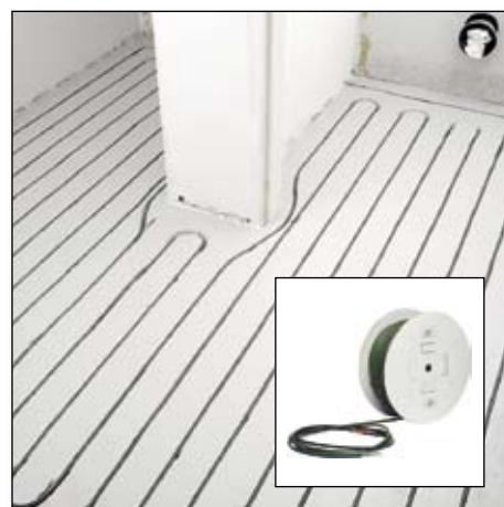
Toiletgroep met ingeslepen verwarmingskabels van 7 mm. (inzet: 7 mm elektrische verwarmingskabel op rol)
